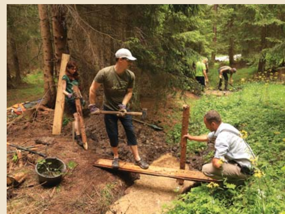
Citlivé ruce dobrovolníků se hodí i při záchraně lesních pramenišť.
